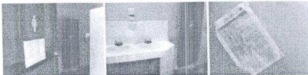
Estado de los baños de uso público
